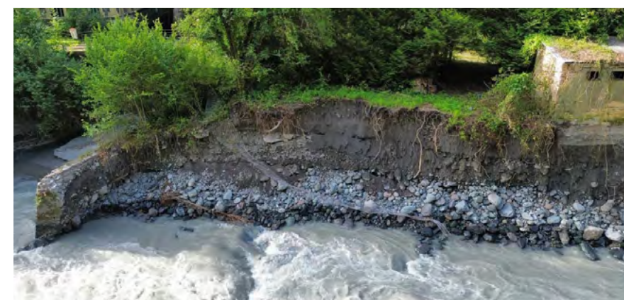
Désordre constatés en juin 2024
